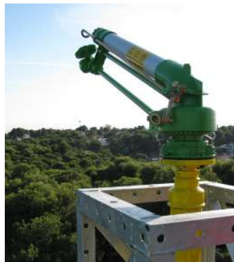
Detalle infraestructura SIDEINFO defensa colectiva
